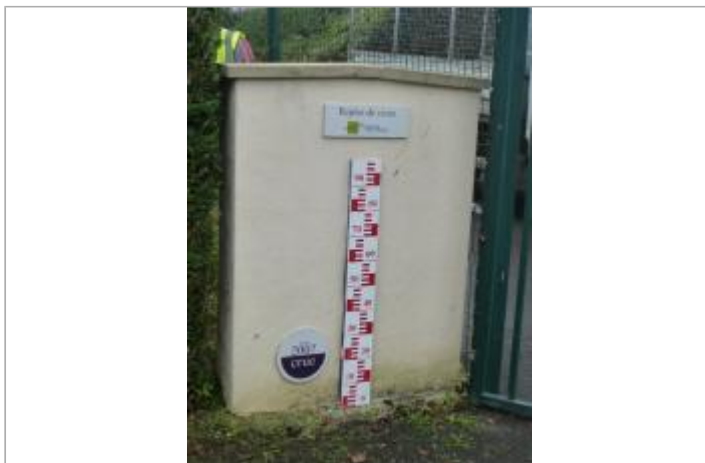
Station de relevage rue Moulin Saint Blaise
