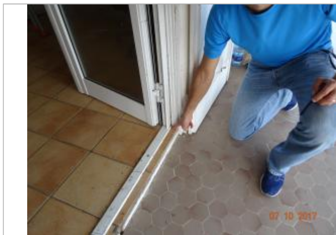
Vue de la PHE - Auteur : Cerema
