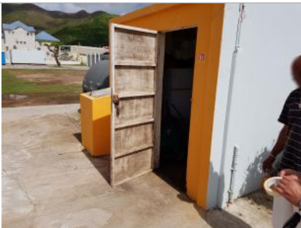
Vue de la PHE - Auteur : Cerema
