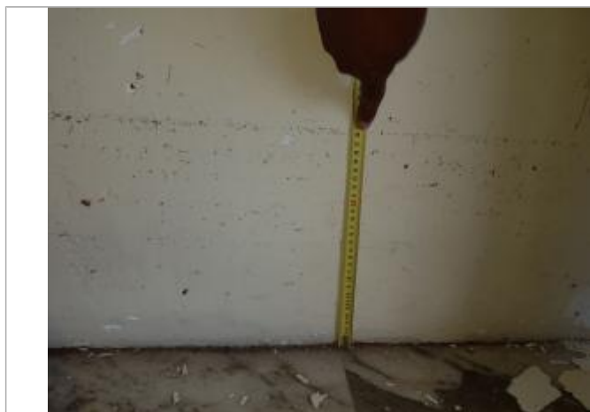
Vue de la PHE - Auteur : Cerema
