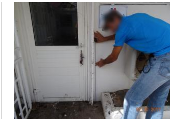
Vue de la PHE - Auteur : Cerema
