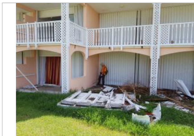
Vue de la PHE - Auteur : Cerema
