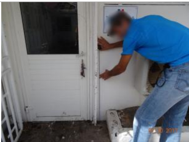
Vue de la PHE - Auteur : Cerema
