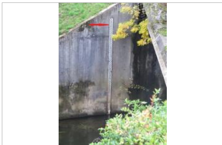
Echelle limnimétrique de la station de Chateaubourg.
