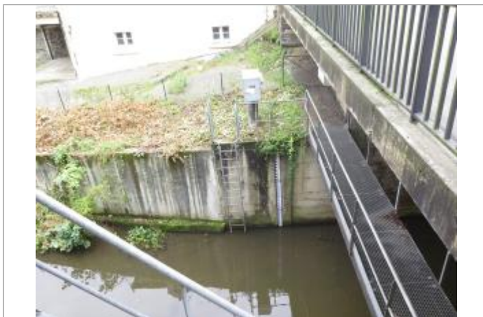
station limnimétrique de Vitré Bas Pont
