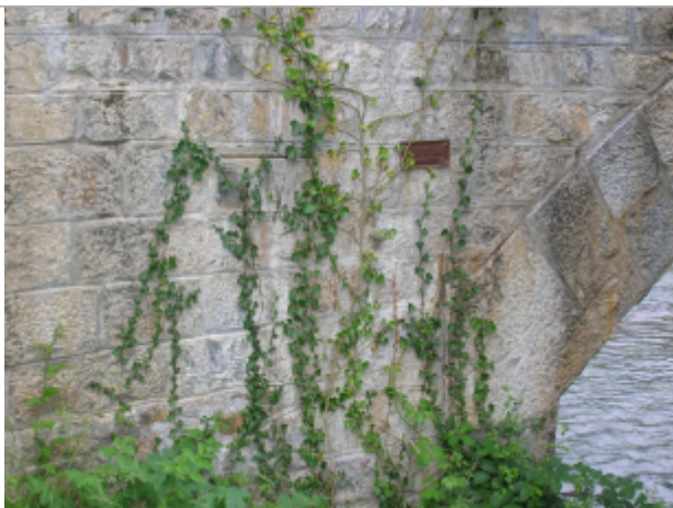
Repères de crue de 1875 et de 1897
