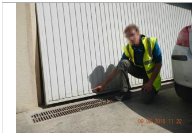
Ligne horizontale sur la porte du garage
