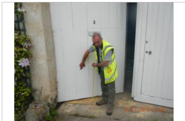
Trace horizontale laissée par la crue sur la porte du garage
