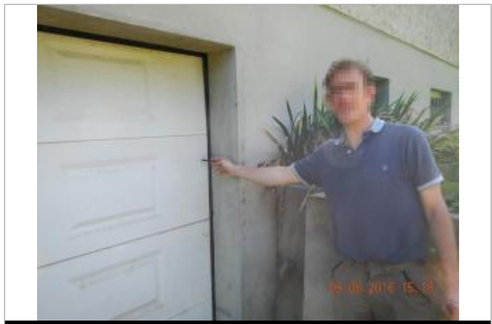
Ligne nette sur la porte du garage enterré
