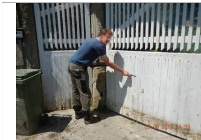
Ligne horizontale laissée par la crue sur le portail de la propriété
