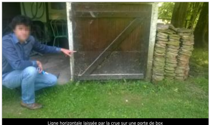
Ligne horizontale laissée par la crue sur une porte de box
