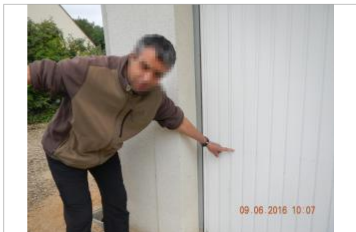
Laisse de crue laissée sur la porte du garage
