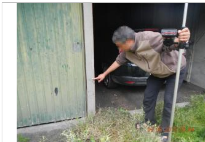
Ligne horizontale laissée par la crue sur les portes du garage
