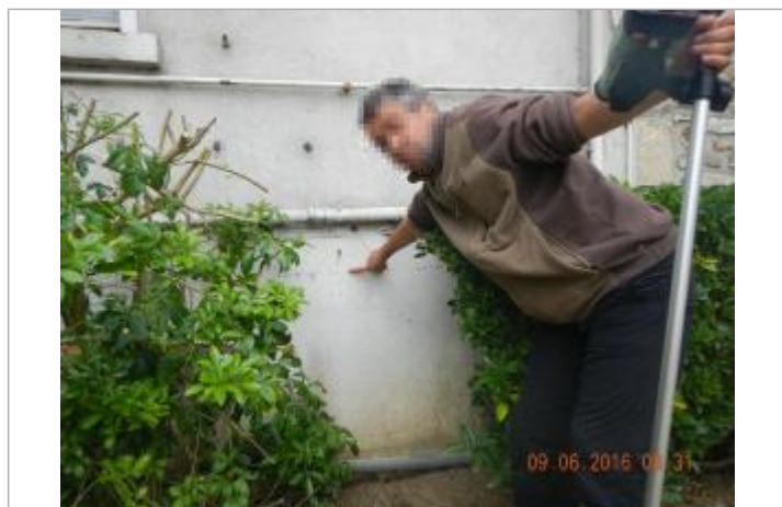
Ligne horizontale laissée par la crue sur le mur dans la cour
