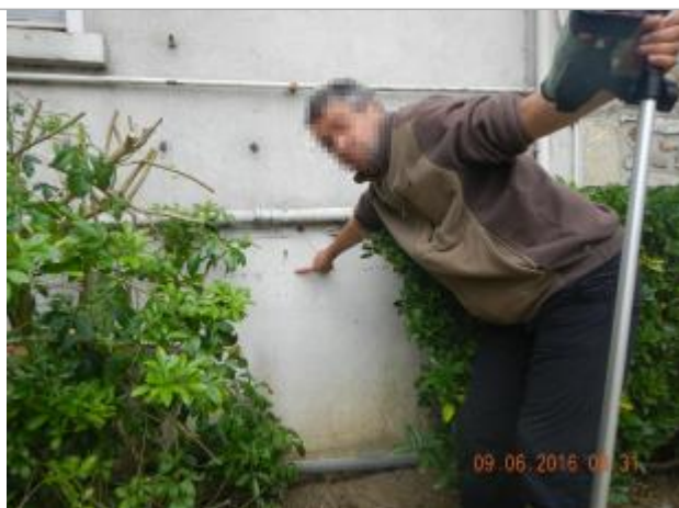
Ligne horizontale laissée par la crue sur le mur dans la cour
