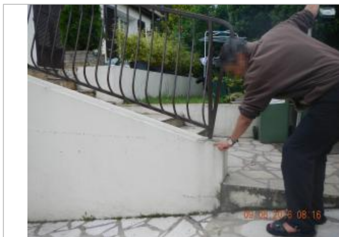
Ligne horizontale laissée par la crue dans la descente du garage
