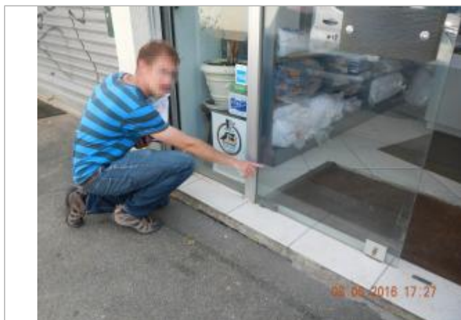
Ligne horizontale laissée par la crue sur la vitrine du commerce
