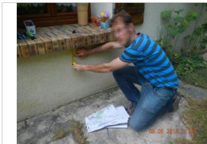
Laisse sous le rebord extérieur de la fenêtre
