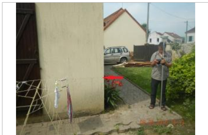
Ligne horizontale laissée par la crue sur le mur extérieur de la maison
