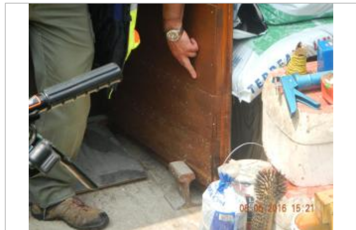
Ligne horizontale très nette laissée par la crue sur l'abri de jardin
