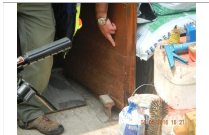
Ligne horizontale très nette laissée par la crue sur l'abri de jardin
