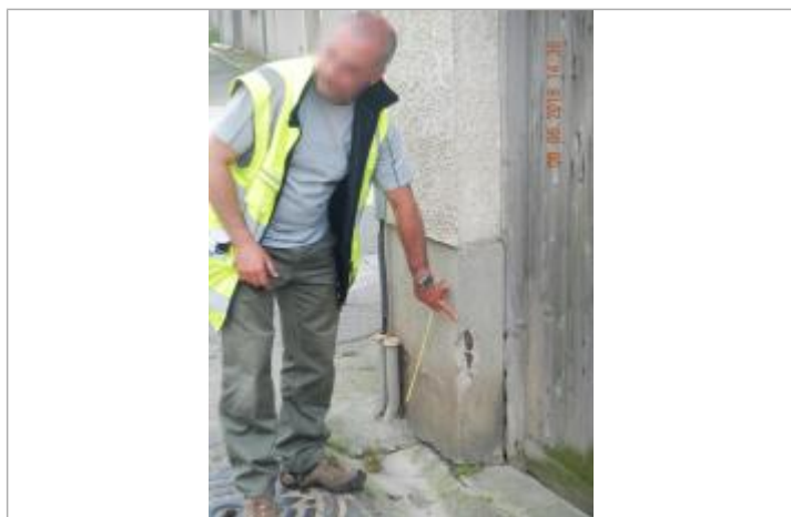
Laisse d'inondation sur la porte
