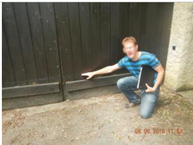
Laisse horizontale laissée sur le portail
