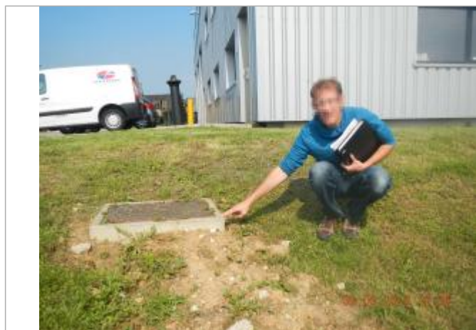
Bouche d'eau usée recouverte de 10cm selon les employés
