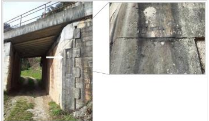
Le repère se trouve sur la culée d'un ancien pont SNCF côté rivière
