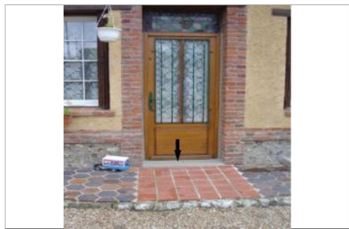
L'eau a atteint le haut de la margelle de la porte d'entrée. (photo ISL)
