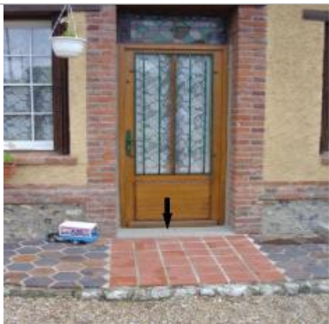
L'eau a atteint le haut de la margelle de la porte d'entrée. (photo ISL)
