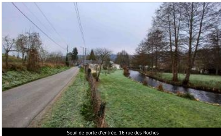
Seuil de porte d'entrée, 16 rue des Roches
