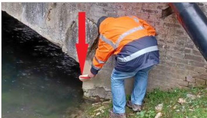
Environ 15 cm sous l'angle entre le mur de soutènement et le départ de la voûte coté amont rive droite.
