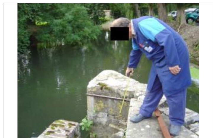
L'eau a atteint un niveau 40 cm en dessous du haut du muret de l'ouvrage (photo ISL)
