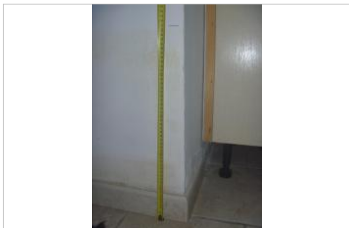
Rue de la Grande Fontaine 6, crue février 2017, hauteur 50 cm
