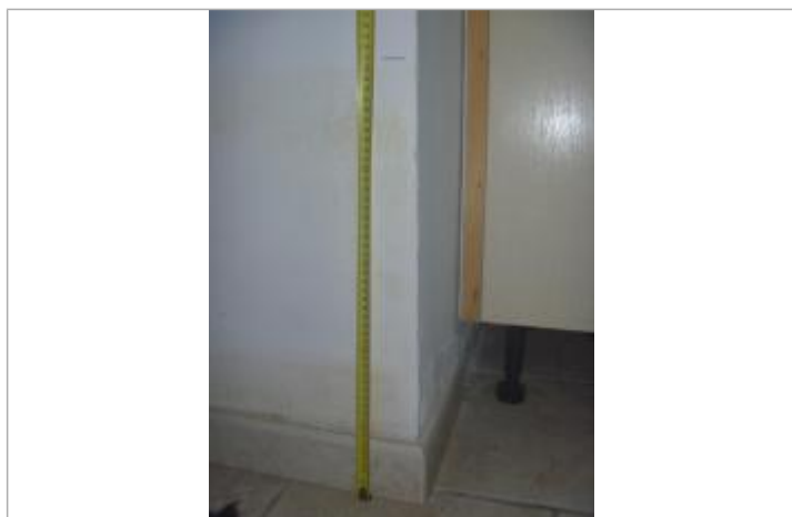
Rue de la Grande Fontaine 6, crue février 2017, hauteur 50 cm
