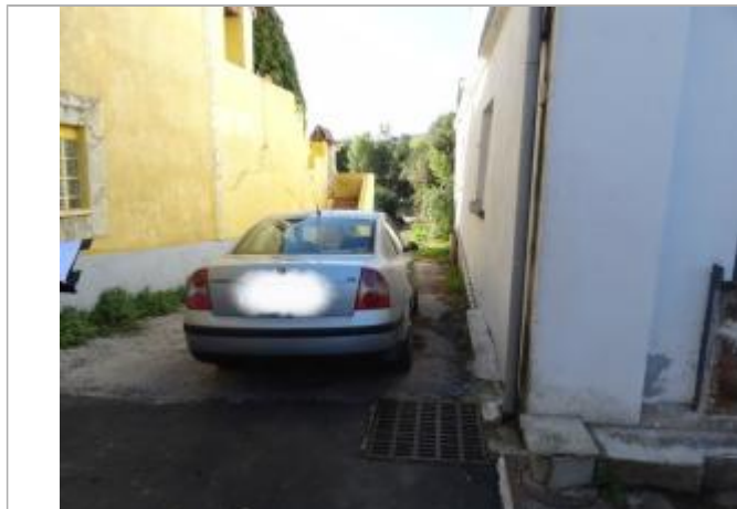
laisse au sol au niveau de l'avaloir
