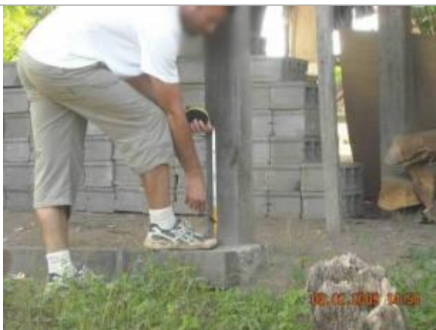
Vue du support et de la mesure du niveau des PHE
