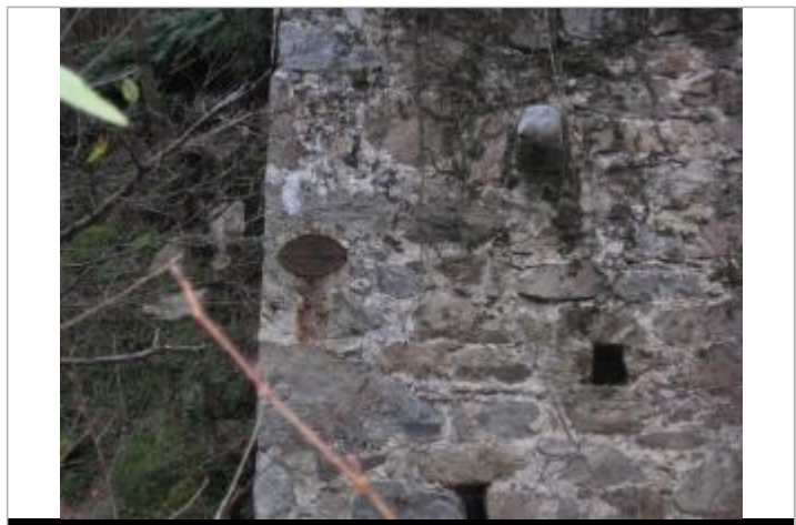
Repère de crue sur arche restant d'un ancien pont - situé sur rive droite de la Cance et sur commune de Roiffieux
