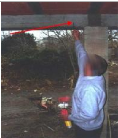
poutre de plancher - rive droite
