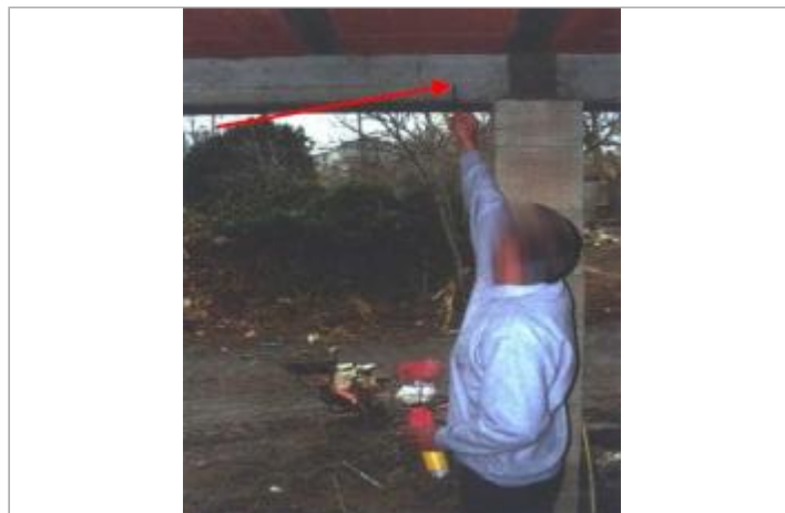
poutre de plancher - rive droite
