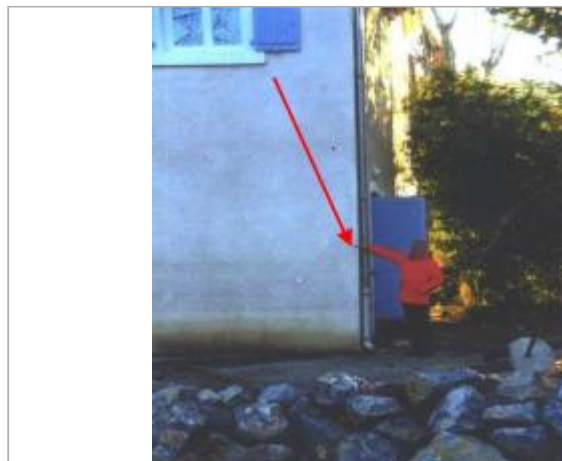
angle de mur de la bâtisse - rive droite
