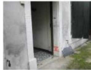
Niveau d'eau à l'entrée de la maison
