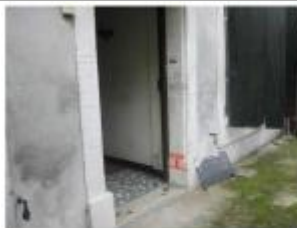
Niveau d'eau à l'entrée de la maison
