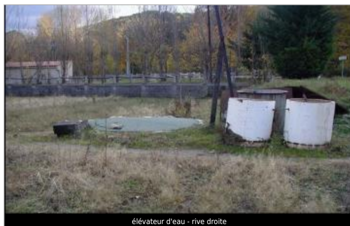
élévateur d'eau - rive droite
