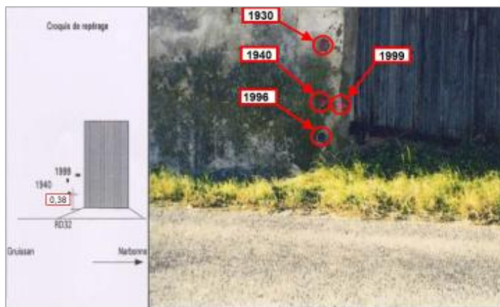
pilier gauche du portail - rive gauche canal
