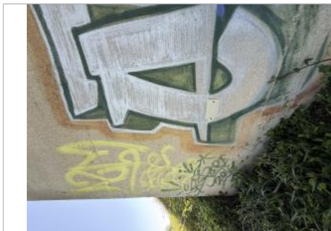
Repère disparu, attaches visibles ?
