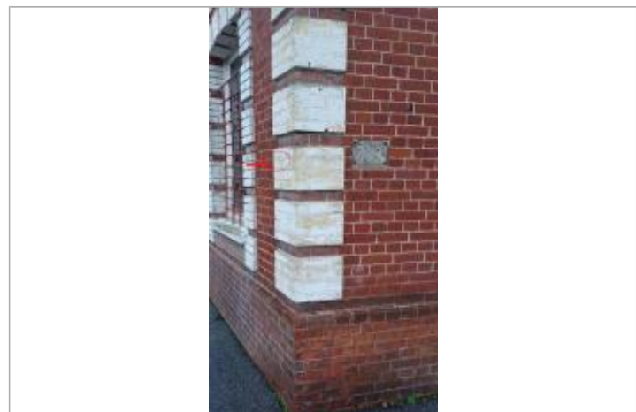
Trace gravée "1966" à 165 cm/sol.
