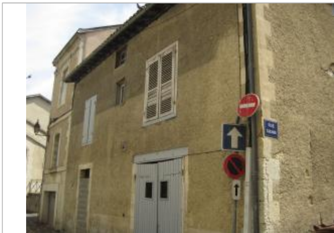
laisse de crue marquant le crépis de la maison, abandonnée, encore visible en 2017
