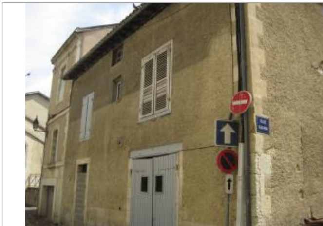
laisse de crue marquant le crépis de la maison, abandonnée, encore visible en 2017
