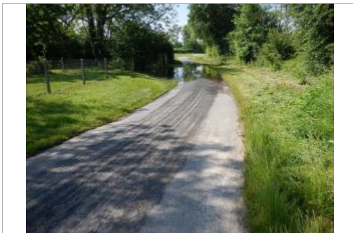
Site pendant la crue
