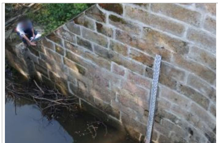
Site et repère de la crue de 2016
