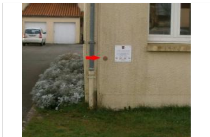
Vue détaillée - Auteur : EPTB_Charente
