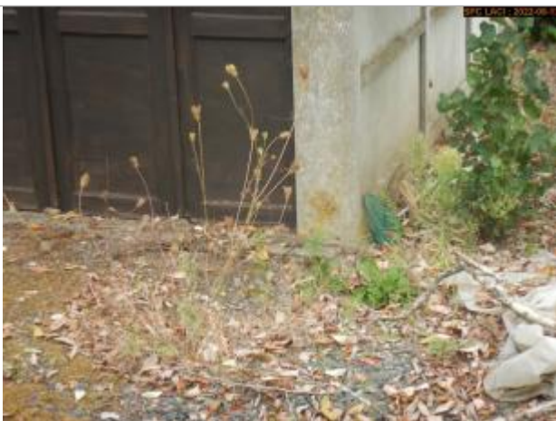
Vue du repère au pied du garrage (11/2008)
